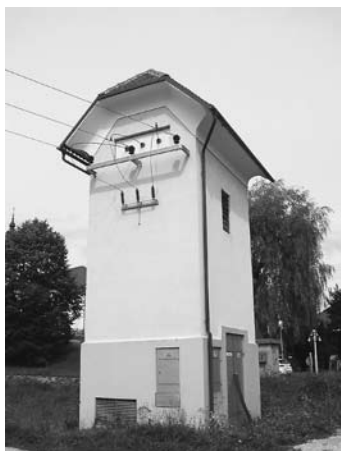
Transformator v Domžalah 453
